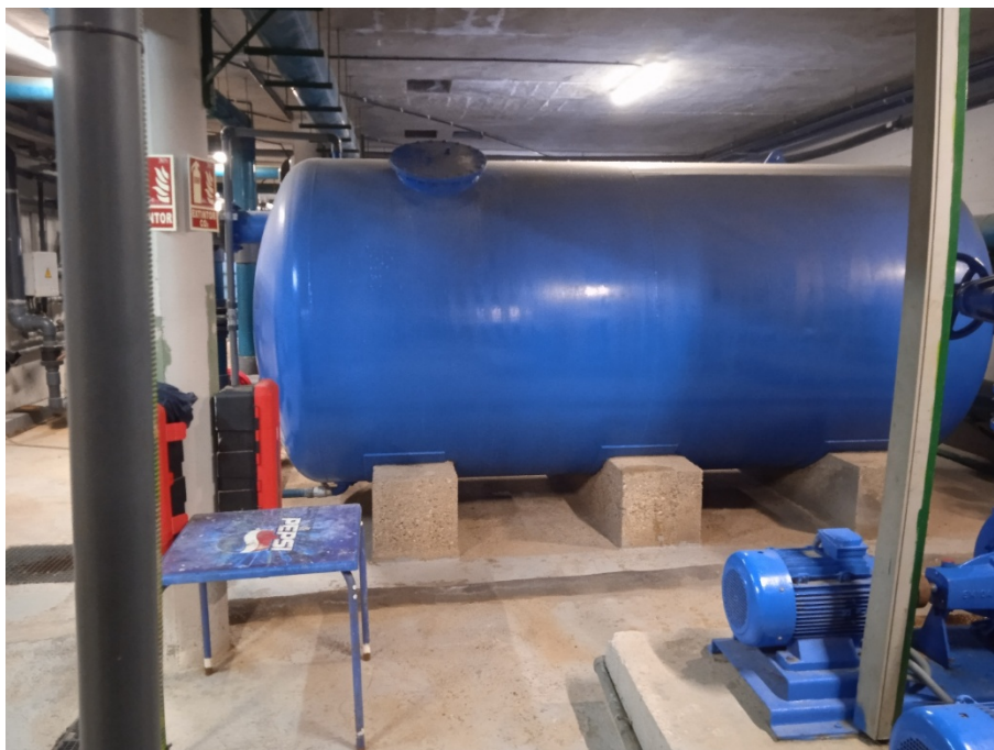
Filtros actuales a sustituir
