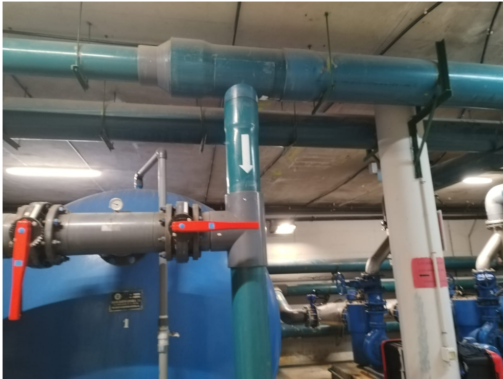
Alimentación de filtros
