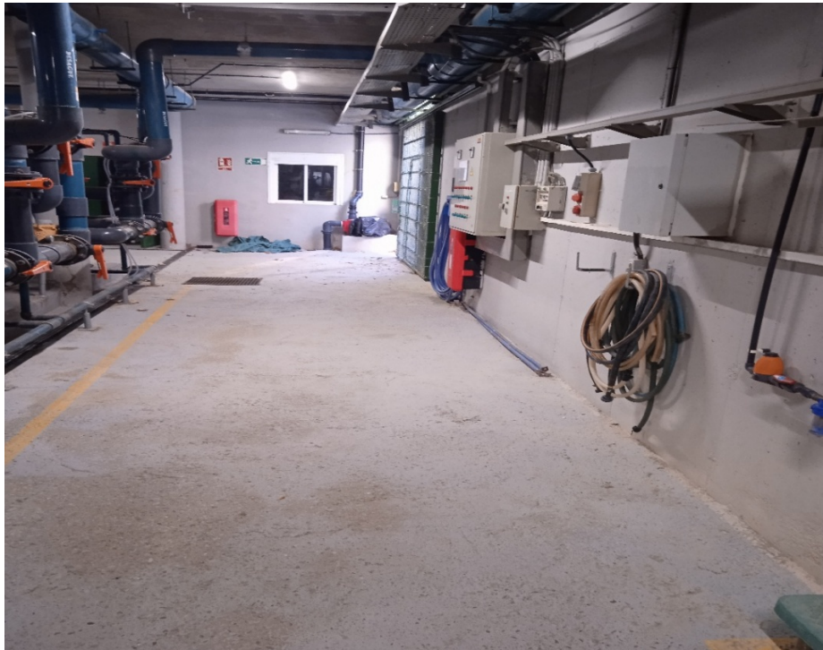
Interior de la depuradora
