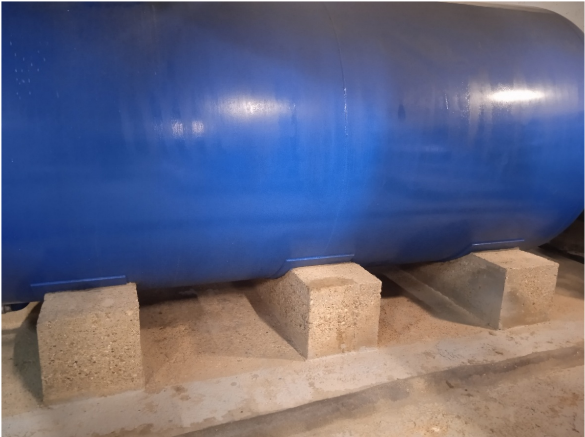
Apoyos de cada filtro
