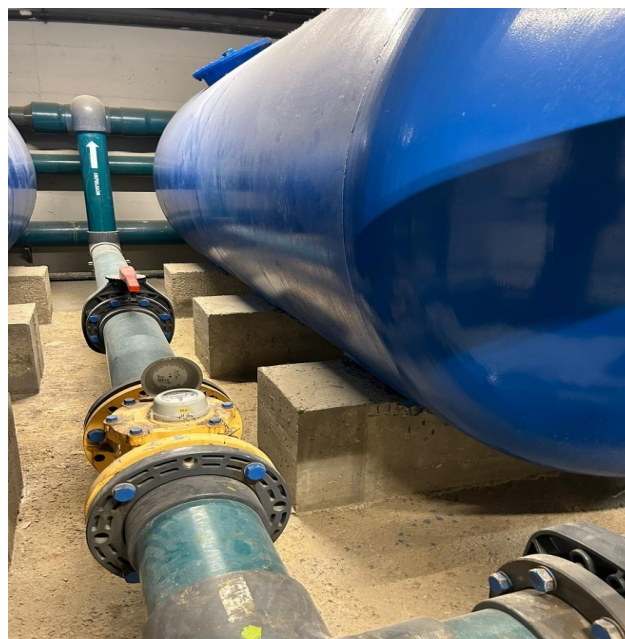
Salida a colector de agua filtrada
